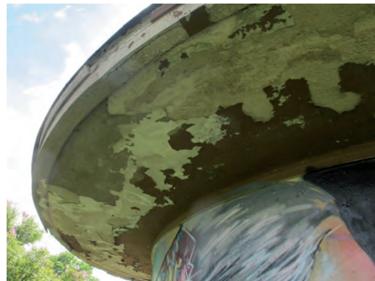
Julkisivujen, räystään ja jalustan vaurioita.
