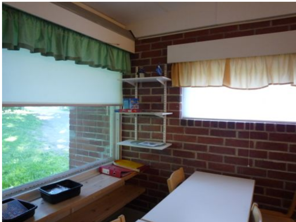
Kylmäsilta osastohuoneen seinässä
