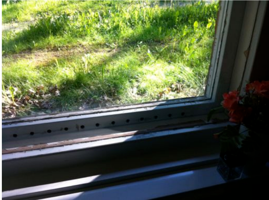
Alkuperäisissä ikkunoissa näkyy kulumisen merkkejä.
