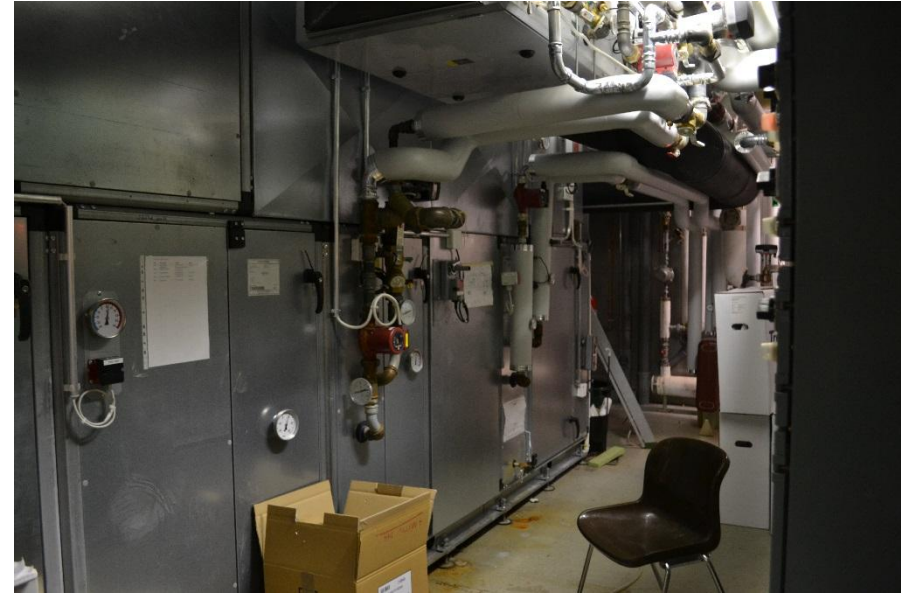
Ilmastointi- ja kosteussäätelylaitteisto vie konehuoneesta suurimman tilan.
