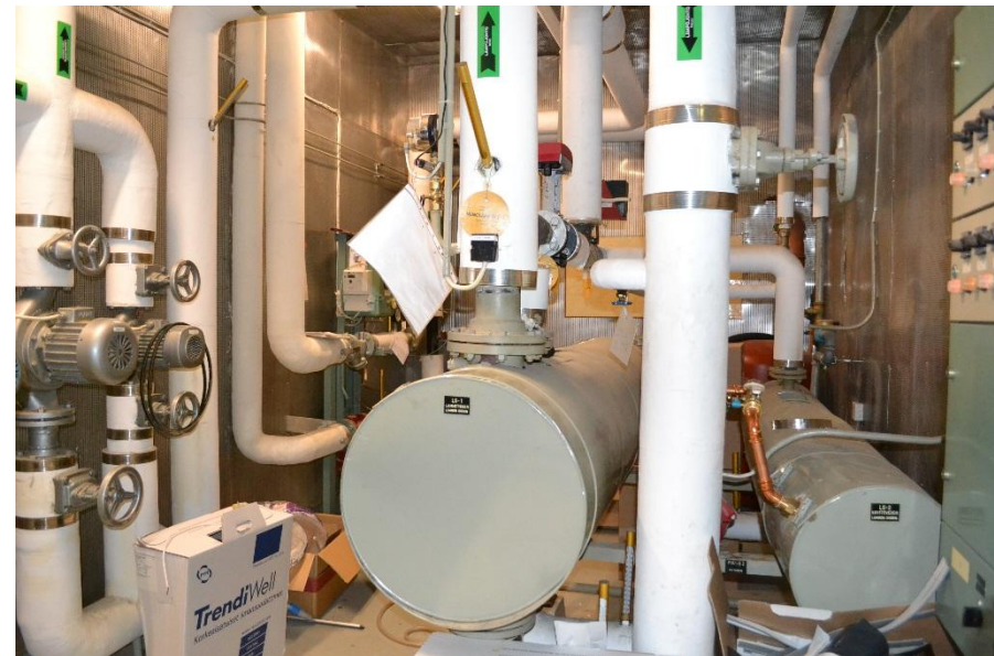
Lämmönjakohuone tilan itäpäädyssä.
