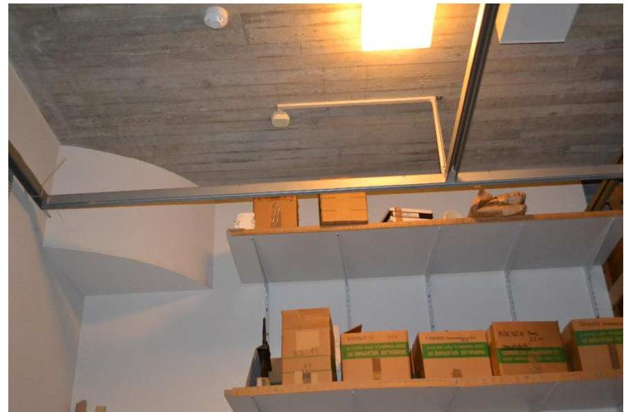
Yksityiskohta koillisnurkassa: tila ilmanvaihtoputkistolle.
