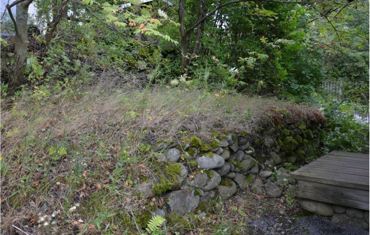
Muuri B (kohta B1) koillisesta. Oikealla näkyy Haulikatu 6:een liittyvä pieni porrasterassi, jonka edustalta pengerrys on osittain sortunut.
