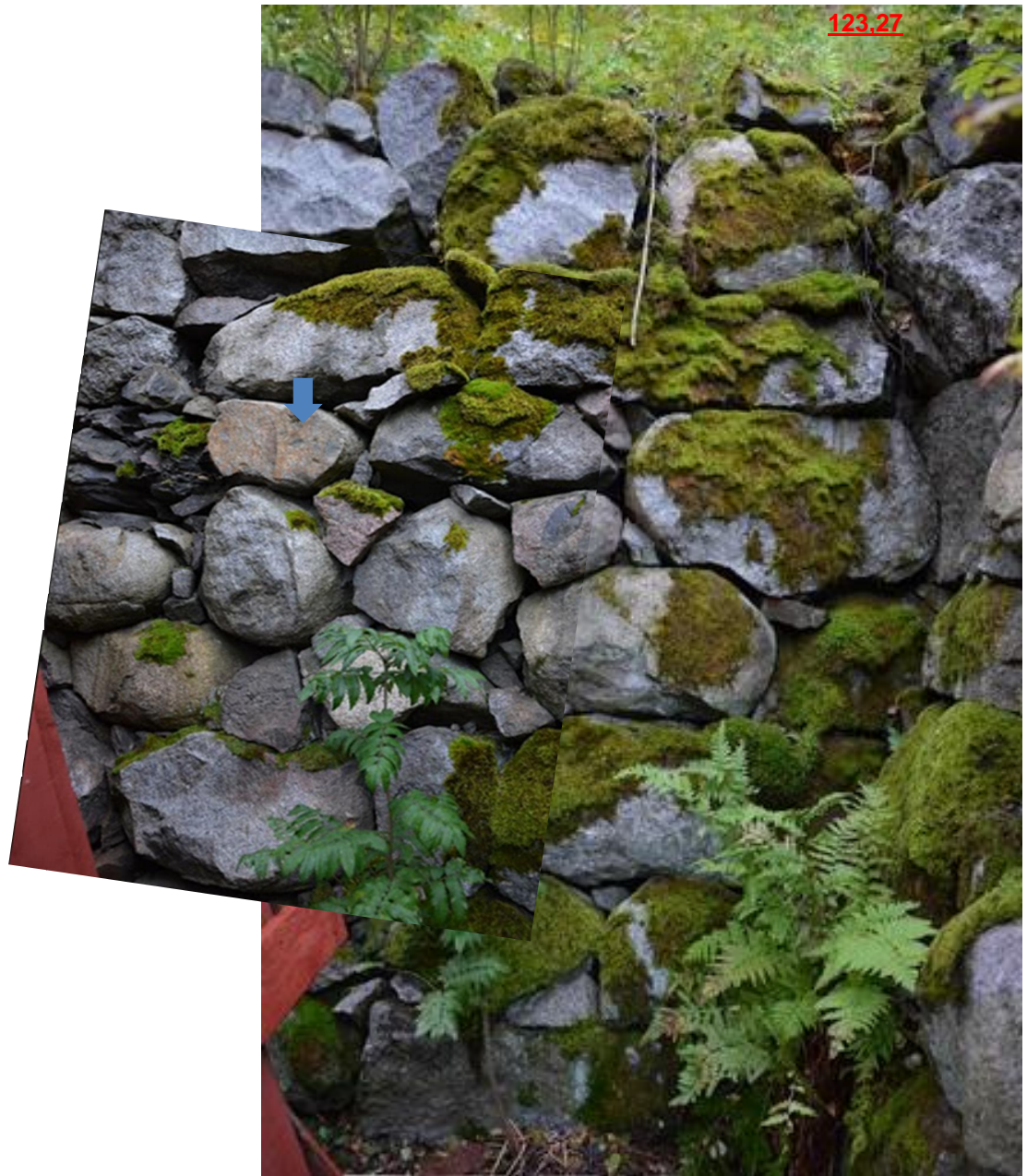
Muuri A (Kohta A4, länsipää) Pohjoisesta. Mahdolliset srpnellin jäljet kivessä nuolella merkittynä.
