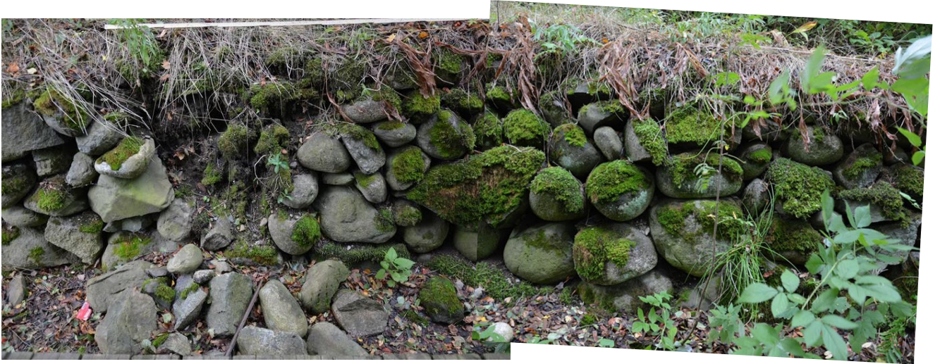
Muuri B (kohta B1) pohjoisesta. Sortuma muurin keskikohdalla. Kahden kuvan yhdistelmä.
