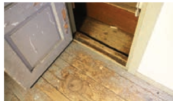
Kuva 112. Lattia peittomaalattua puuta. Lattian maali on lähes kokonaan kulunut.
