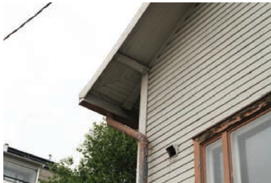
Kuva 13. Syöksytorvet peittomaalattua peltiä. Maalipinnat huonossa kunnossa.
