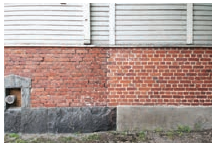
Kuva 35. Sokkelissa vasemmalla puolella graniittia ja punatiiltä, oikealla puolella vaaleampi 1950-luvun laajennuksen betoni- ja punatiilisokkeli.
