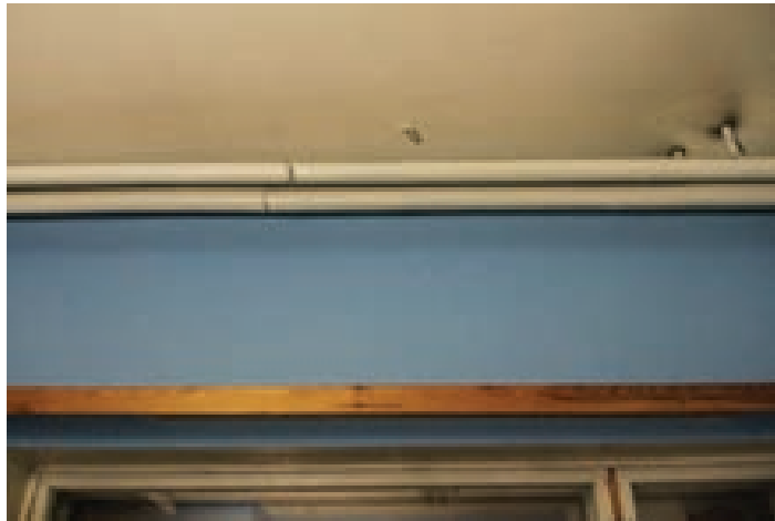
Kuva 115. Puiset verholistat. Katossa peittomaalattu tasoite.
