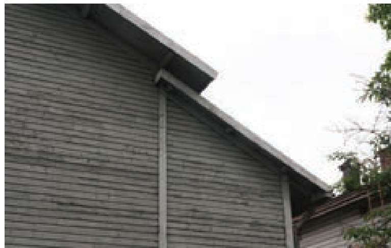
Kuva 24. Julkisivumateriaali höylättyä pontattua vaaleanharmaata vaakaverhouslautaa. Julkisivuverhoilu huonossa kunnossa.
