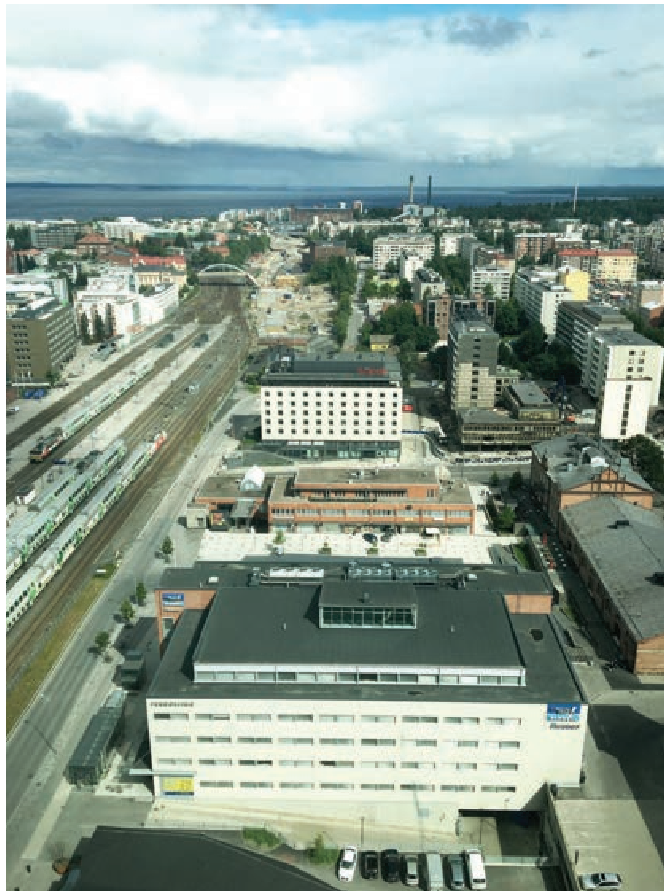
Kuva 42. Näkymä Tornihotellista Näsijärven suuntaan. Edessä näkyvän Scandic-hotellin vasemmalla puolella näkyy siirrettävä Tavara-asema ja Scandic-hotellin oikealla puolella purettava rastian kortteli, jossa purkutyöt on aloitettu.
