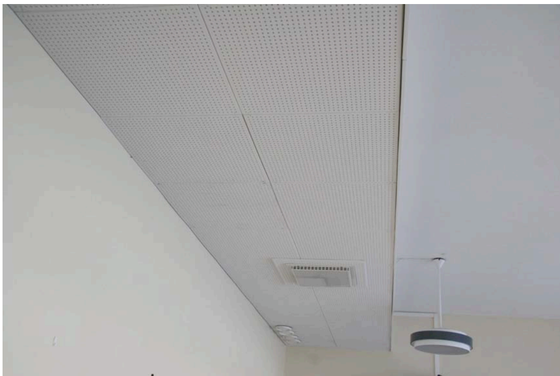
Kuva 23. Vanhaa vaimentavaa kattoverhousta
