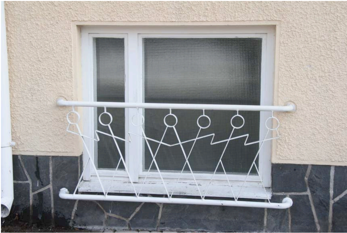
Kuva 7. Pohjakerroksen ikkunan suojakaide ”juoksevat lapset”
