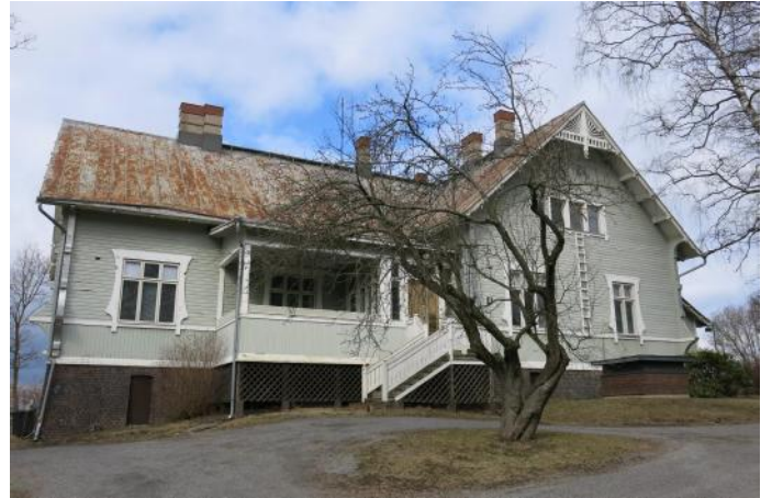
Ryselinin talon kaakkoissivulle on 1900-luvun puolenvälin jälkeen lisätty parveke ja alkuperäisen kuistin sisäänkäynti on muutettu kuistin lounaispuolelta sen kaakkoispuolelle. Kuva: Miia Hinnerichsen, Pirkanmaan maakuntamuseo 2016.
