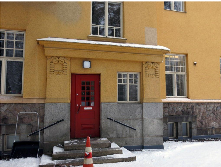
Sisäänkäynti länsisivun porrashuoneeseen (A). Pilasterien päiden koristeaiheet on toteutettu kasviaiheisina. Julkisivujen uudelleenrappaus on tehty koneellisesti. Rappaus on vedetty suurpiirteisesti myös koristeaiheiden päälle.
