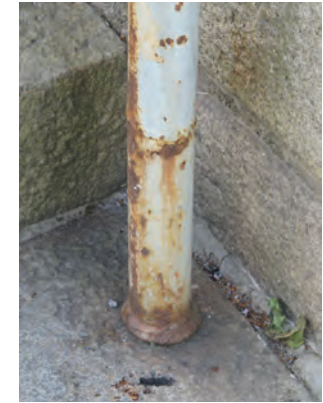
Pääportaan kaiteen ruostunut juuri.
