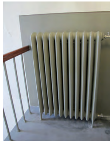
Kirjaston alkuperäinen lämmityspatteri.
