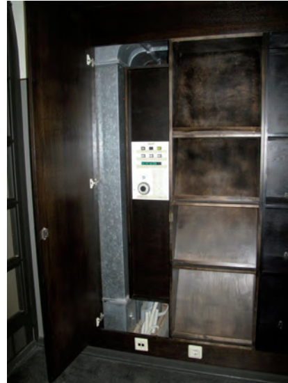
1. kerroksen kalusteeseen integroitu iv-putki ja sähkötaulu.
