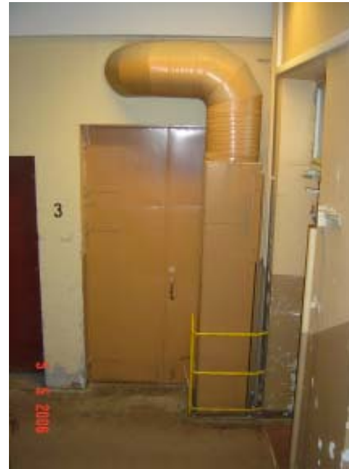
Ilmanvaihtokanava on tukkinut alkuperäisen kulkuoven
