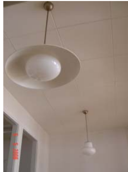
Pohjoissiiven konttoritilojen opaailiasivalaisimia
