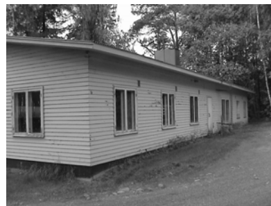
Poikala ei edusta rakenteiltaan kovin laadukasta rakentamista.
