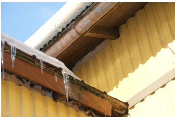
Vanhaa punertavaa rappauspintaa on nähtävissä räystäärajassa pellityksen alla.
