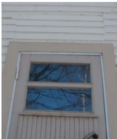
Kuva 22. Laudoituksessa näkyvä paikka oven yläpuolella.
