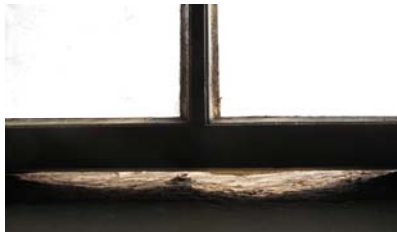
Kuva 14. Kuluma kellarin ikkunan karmissa.
