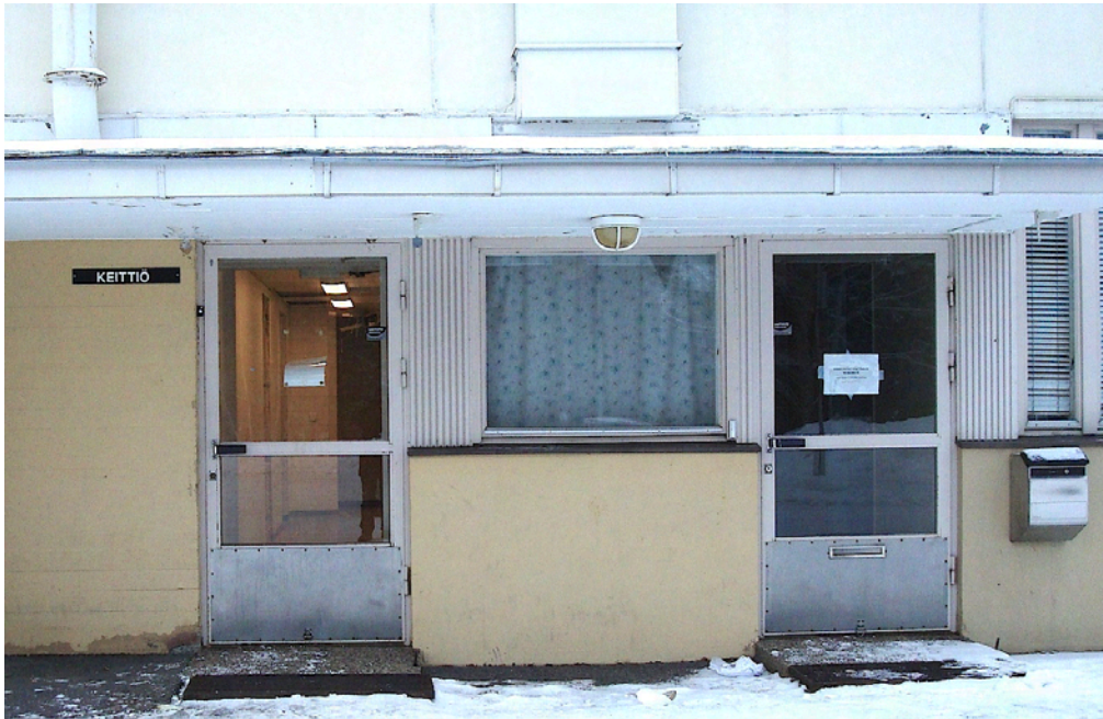
Kuva 9. Keittiön ja neuvolan alkuperäiset ovet.
