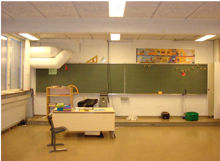
Kuva 23. Perusopetustila, jossa jälkepäin tehtyjä ilmanvaihtoasennuksia. Luokkatilojen katoissa on puukuitueristelevyjä (Toja-levy) vaimennusmateriaalina.
