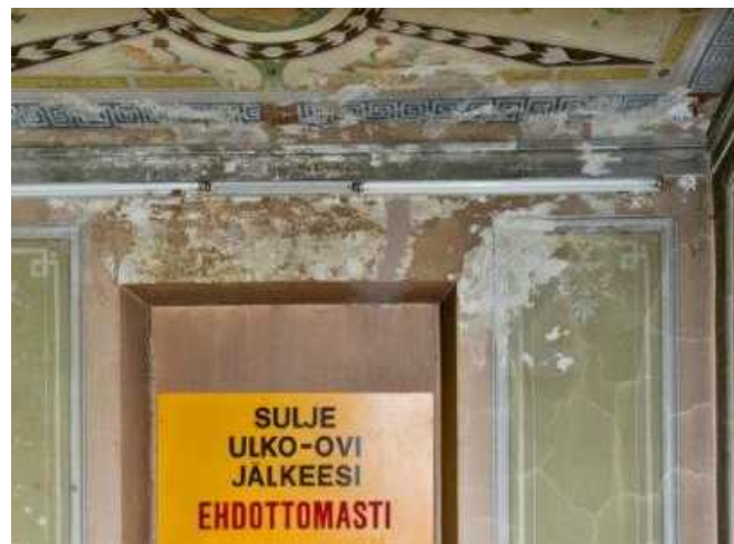
Vesivaurioita ensimmäisellä kerrostasanteella (seinäpinta S8 ja kattopinta K3). RT
