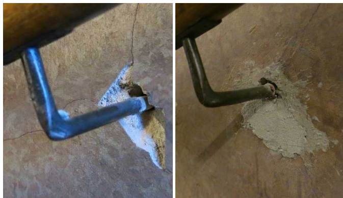
Löystynyt ja kömpelösti korjattu käsijohteen kiinnitys. MH
