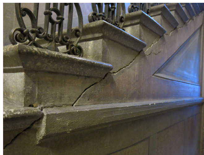
Ilmeisesti perustan liikkumisesta seurannut murtuma (seinäpinta S4) MH
