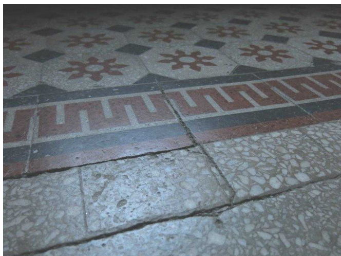
Kerrostasanteen lattiapinnan halkeama (lattiapinta L9)
