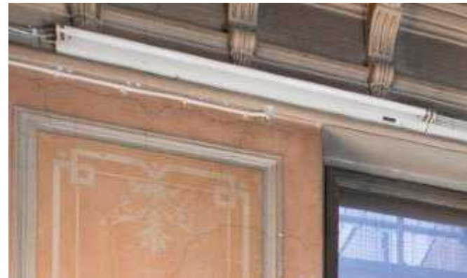
Porrashuoneen valaisimina on yksinkertaiset seinille kiinnitetyt loisteputkivalaisimet. Kaikki sähköt on vedetty pinta-asennuksina. RT
