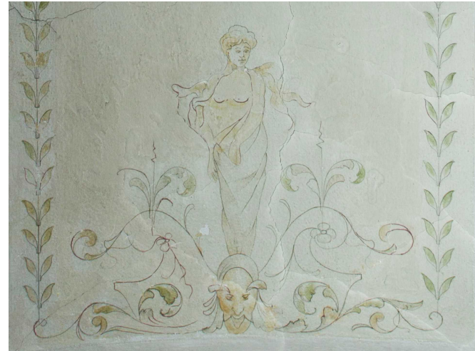
Porrashuoneen eteistilan kattomaalauksen (kattopinta K1) maalipinta on pääosin kadonnut, luonnosviivat näkyvät. RT
