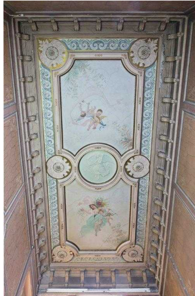
Sandbergin talon A-rapun porrashuoneen kattoa kannattelevat koristeconsolit. Maalaukset ovat herkin pastellisävyisiä ja enkeliaiheisia. RT
