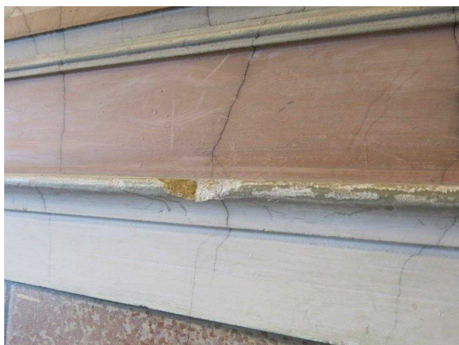
Kerroslistan lohkeama ja seinän hiushalkeamia (seinäpinta S22). MH
