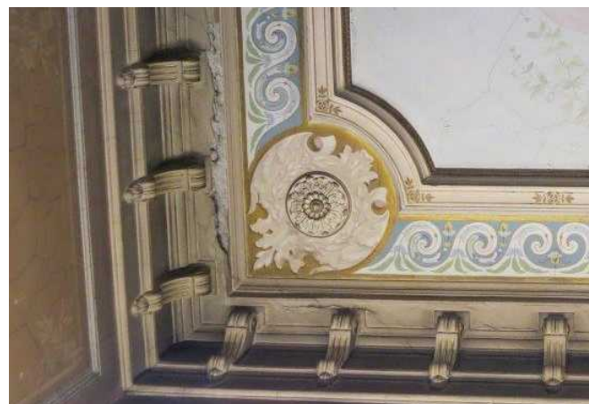
Hiushalkeamia ja kattolistan lohkeama (kattopinta K8). MH
