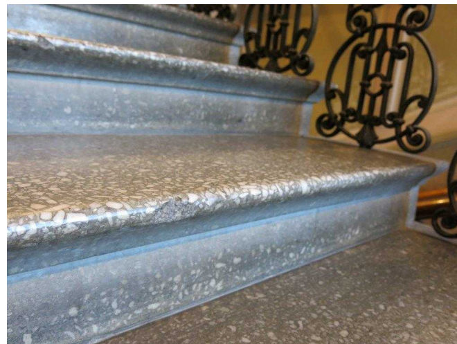
Porraskelman etureunan lohkeama (lattiapinta L10). MH
