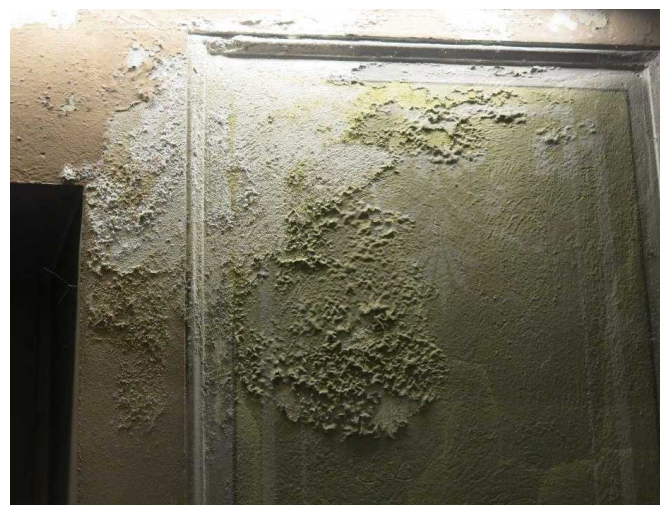
Vesivauriota ensimmäisellä kerrostasanteella (seinäpinta S8). RT
