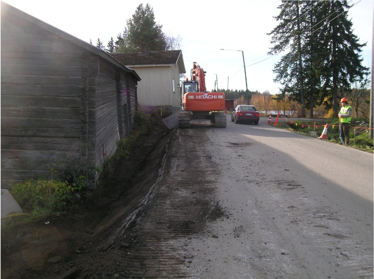
Kuva 20. H-alueen koillisosaa Kaipilan hirsinavetan luoteisseinustalla. Vaalea rakennus hirsinavetan takana on Sapalan koillinen asuinrakennus kylämäen laella. Tien oikealla puolella E-alue ja Kierikantien liittymä. Taustalla näkyy Pyhäjärven Kotolahti. Kuvaussuunta lounaaseen. Kuvaaja: Sami Raninen. KYY 130: 43.
