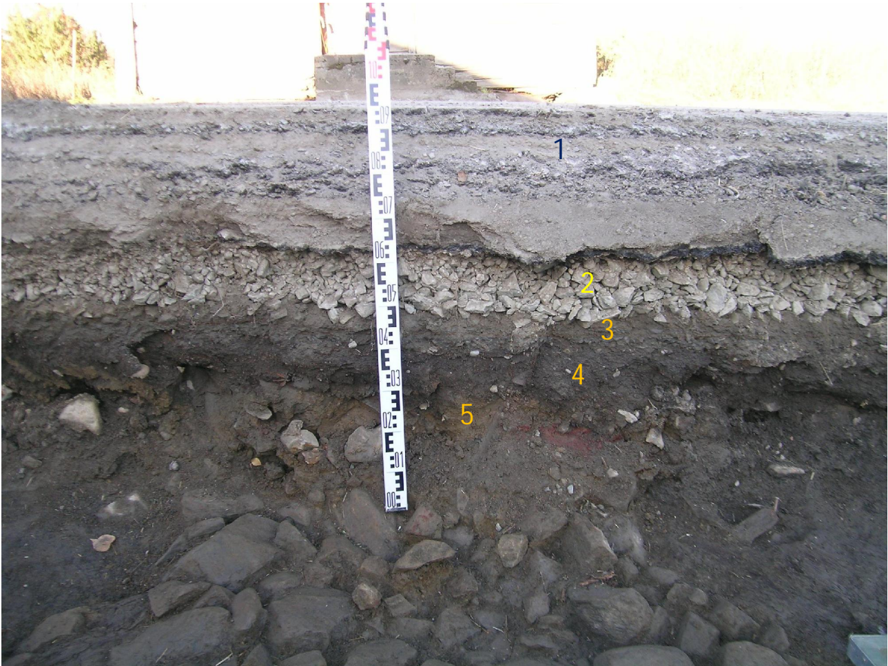
Kuva 19. G-v-alueen luoteisprofiilia rakenne G-KR1:n kohdalla. Anian rantatien toisella puolella Kaipilan aitta (kuvassa erottuvat parhaiten aitan betoniportaat). Kuvaaan merkittykerrokset: 1) asfalttikerrokset, 2) sepelikerros, 3) tummanharmaa hiekkakerros, 4) tummanharmaa savimultakerros, 5) kellertävänruskea hiekkakerros G-Y2. Kuvaaja: Sami Raninen. KYY 130: 19.
