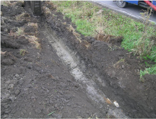
Kuva 11. Maakaapelikaivannon koillisosaa isojakokartassa kuvatulla peltoalueella. Esiin tulee vain Anian rantatien pengerluiskan resenttiä täyttömaata ja harmaata savea, jossa ei ole viitteitä kiinteästä muinaisjäännöksestä. Kuvaussuunta itäkoilliseen. Kuvaaja: Sami Raninen. KYY 130: 35.
