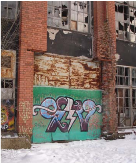
Kuvat ylhäältä alas: Tehtaan pohjoiskulma ja piippu Betonisilta ja puuparivoi Eteläjulkisivun 1970-luvulla levennetty aukko
