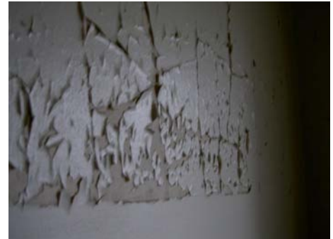
Kuva 104 yläpuolella Porrashuoneen seinän hilseilevää maalipintaa
