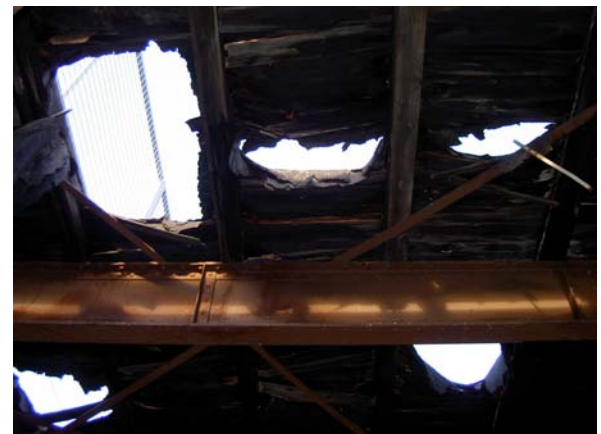
Kuva 44 alhaalla Peltimakasiinin radanpuoleisen laiturikatoksen katon puuosat ovat paikoin lahonneet, mutta jyrävä teräskannattaja on edelleen kunnossa.
