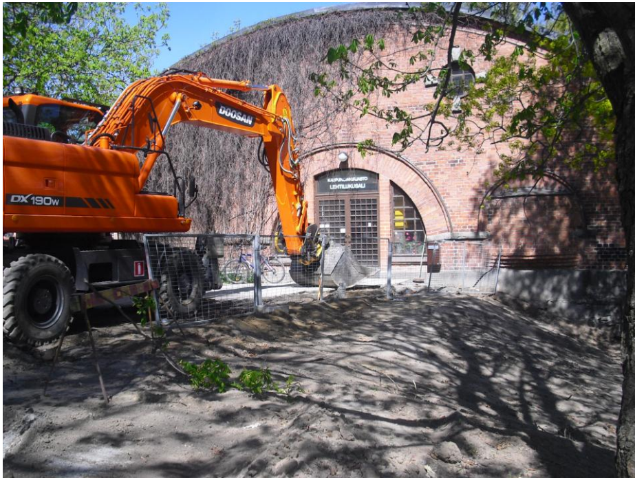
Kuva 41. Lukusalin edusta. Metalliaidan kohdalla menee kaukolämpö putket. Ranisen E-alue alkaa kuvan vasemmasta alalaidasta. Kuvaussuunta SE.
