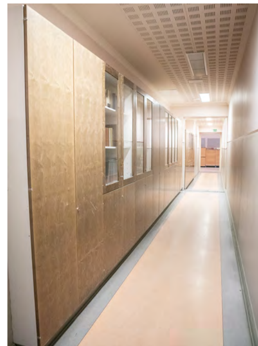
1990-luvulla rakennettu pitkä käytävä 1. kerroksessa yhdistää itä- ja länsipään porrashuoneet ja käytävät toisiinsa.
