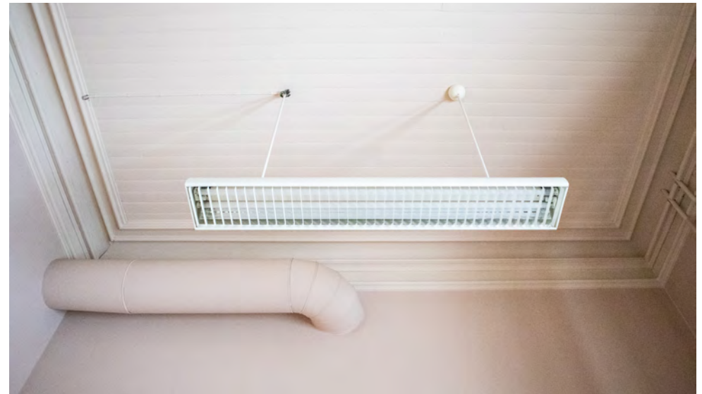
Ylempi kuva: valaisin ullakkokerroksessa. Alempi kuva: Osassa opetustiloja puupaneelikatto on kokonaan näkyvissä. Kattovalaisimet ovat 30 vuotta vanhat 1990-luvun peruskorjauksesta. Takana seinää läpäisee IV-putki.
