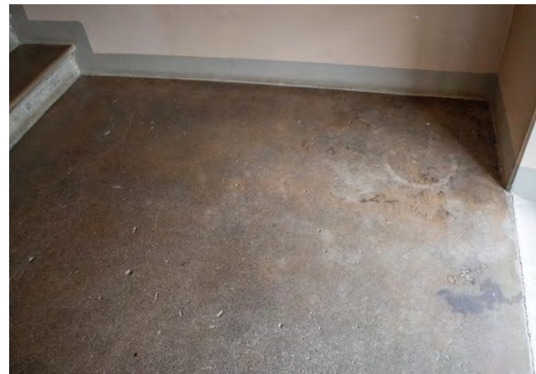
Patinaa kivisissä porrastasanteissa
