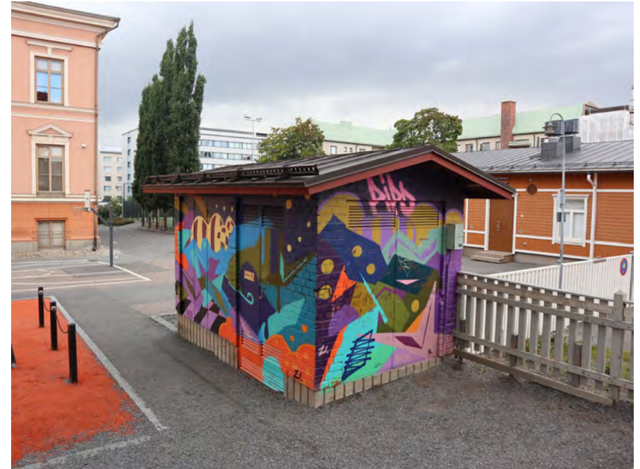
Tiilen ja maalattu muuntaja pohjoisella pihalla
