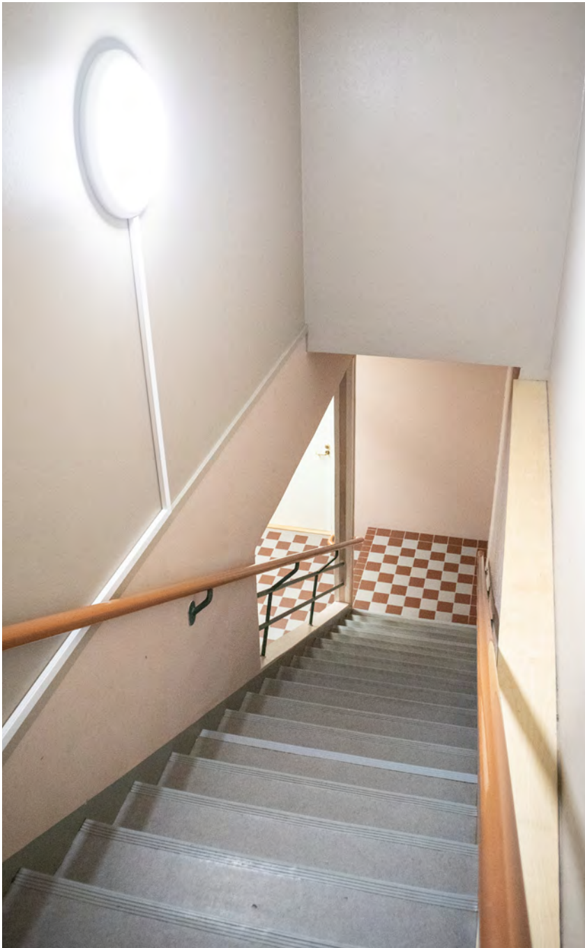
Voimistelusalin takaosaan on rakennettu kellarin puku- ja pesuhuoneisiin joh- tava sisäporras peruskorjauksessa
