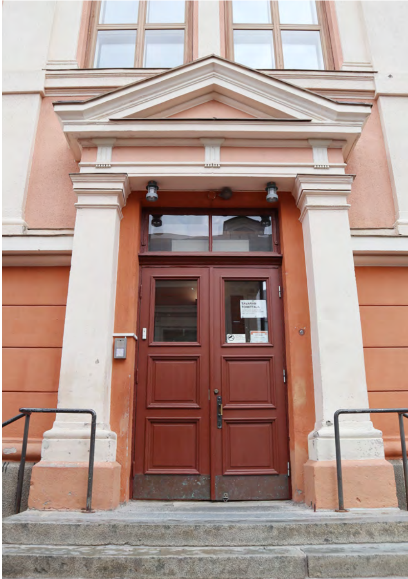
Eteläinen sisäänkäynti - Sisäänkäyntiä kehystävät pilarit ovat etelässä kullmikkaat - Tämä voi johtua sotien aiheuttamista julkisivuvaurioista ja niiden korjauksista, sillä tarkempia muutoksia ei arkistosta löydy. Alkuperäinen pilarimuoto oli molemmilla julkisivuilla pyöreä. Kuvassa näkyviä ulko-ovia ja ikkunoita on uusittu peruskorjauksessa.
