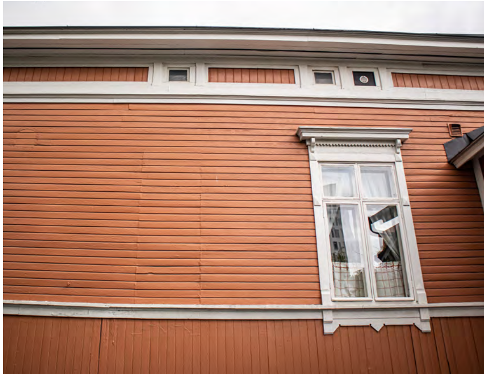
Itäjulkisivulta peitetty alkuperäinen ikkuna-aukko näkyy arvoituksellisesti julkisivulaudoituksessa. Vasemmalta puolelta on myös peitetty pyöreä ilmanvaihtoaukko. Kuvan ristikarmillinen ikkuna poikkeaa kaikista muista rakennuksen T-karmillisista ikkunoista.
