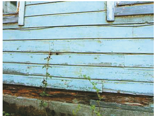
Pytinkirakennuksen luoteisseinän alimman hirsikerran lahovaurio. (Kuva: Kantonen, 1999)
