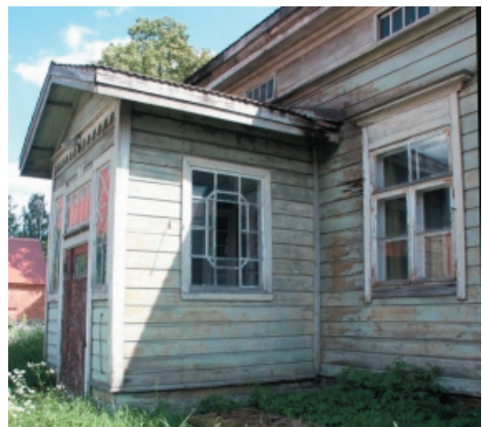
Kuistin katto kaataa vedet julkisivuun päin.
