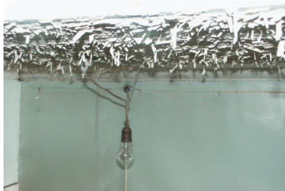
Pirttirakennuksen sisäkattomaali on päässyt paikoin hilseilemään.
