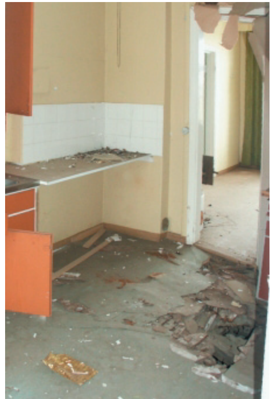
Pytinkirakennuksen vesivahingon seurauksena lattia on osin romahtanut.
