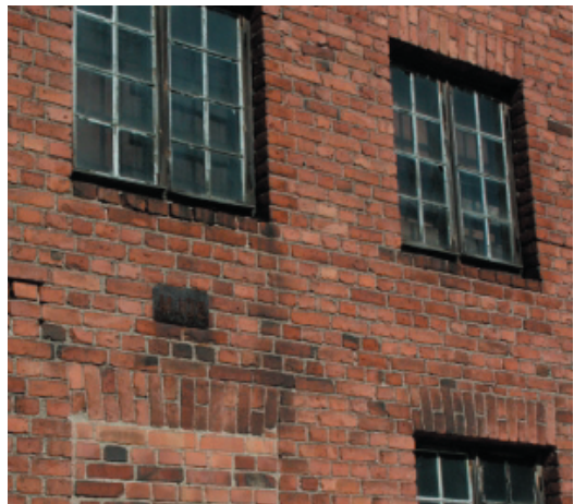
Myllyn hienot ikkunat kaipaavat kunnostusta.
