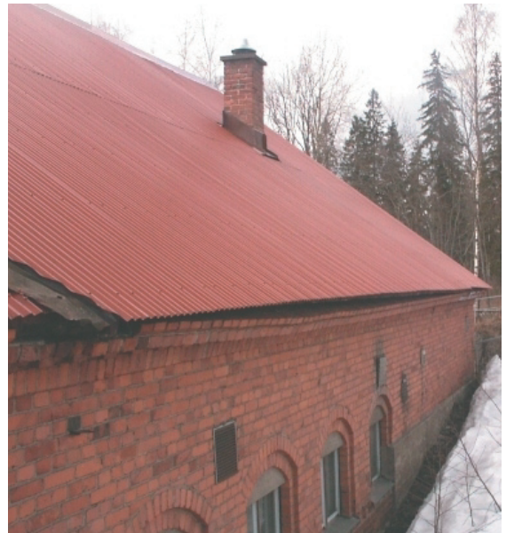
Navetan koillisseinän räystäästiilet ovat notkahtaneet.
