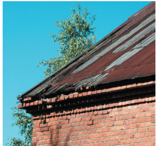
Myllyn huonokuntoista kattoa ja räystästä rakennuksen eteläkulmalla.
