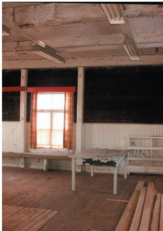
Näkymä pirtistä. Följrit ja puolipanelointi ovat maalattuja. Katossa näkyy kosteusvaurion jälkiä ja lattiaa on jouduttu samasta syystä osin uusimaan.
