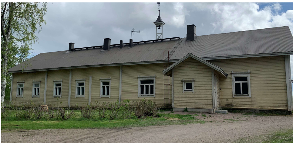
KUVA 59. Rakennuksen pohjoisjulkisivu tällä hetkellä. Etenkin kuvan oikeassa reunassa näkyy pohjoisjulkisivun kosteusvaurioita johtuen puuttuvista ränneistä. (l. Peltomäki)
