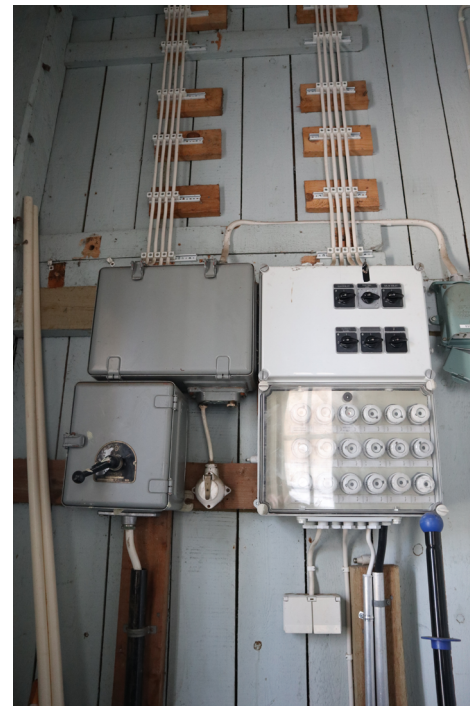
Sähkökeskus idän puoleisessa kassassa
