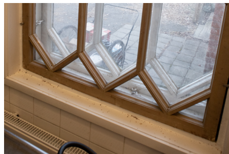
Ravintolan keittiön sisäpuolelle on lisätty ikkunalasit 1970-luvulla (ruskeaksi maalatut puitteet, jotka ovat siipisäpeillä kiinni karmissa)
