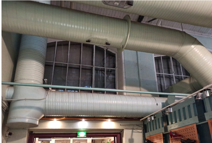
Sisäänkäyntisiipien yläpuoliset iv-konehuoneet peittävät osan ikkunoista.
