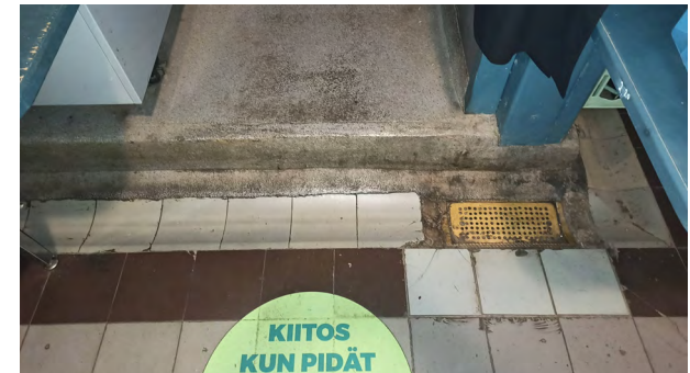
Vesikouru ja viemäri kojun edustalla.
