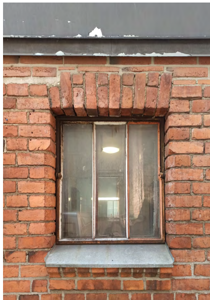
Sisäänkäyntisiiven kippi-ikkunan maalipinta on kärsinyt.
