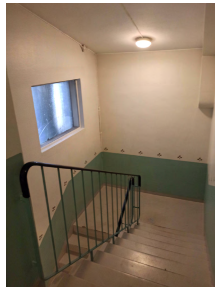
Porrashuoneen ikkunan rautalan- kalasi on rikkoutunut.
