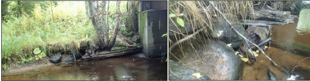
Joen ylittävän sillan pohjoispuolella, joen itärannalla hirsirakenteen jäännös. Mahdollisesti aikaisemman sillan silta-arkun osa.
