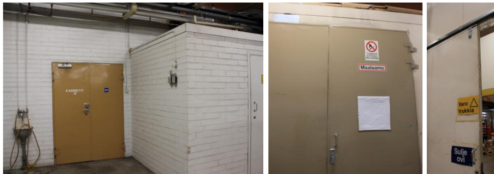
Kuva 14. Sisätiloissa on säilynyt yksityiskohtia 1970-luvulta. Vasemmalla: Todennäköisesti alkuperäinen ovi tuotantohallista toimistosiipeen. Vuoden 1979 laajennuksen yhteydessä toimistosiipeen sijoittuneita pukuhuoneita on laajennettu tuotantotilojen puolelle. Keskellä: Alkuperäisen tehdashallin keskelle sijoittuneen maalaamon ovi on alkuperäinen. Oikealla: Tehdashallin osiin jakavan väliseinän alkuperäinen liukuovi.
