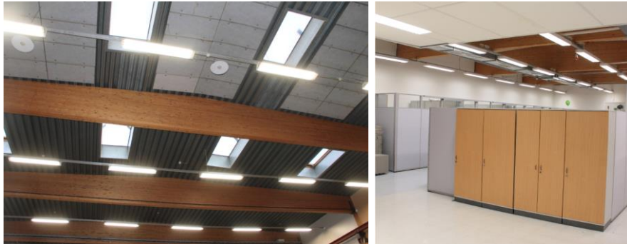
Kuva 13. Vasemmalla: Kattoa kannattavat liimapuupalkit näkyvät hyvin teollisuushallin sisätiloissa. Teollisuushalliin tulee valoa kattoikkunoiden kautta. Oikealla: Toimistoparven ja yläkerran toimistotilojen ilme on 2000-luvulta.
