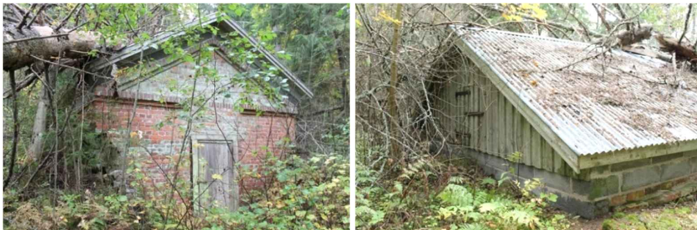
Metsäkellarin ympärillä kasvaa tiheää pusikkoa ja rakennuksen päälle on kaatunut puu.
