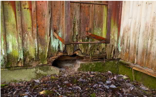
Asuinrakennuksen lahonneutta julkisivulaudoitusta ja lohkeillut perustus.
