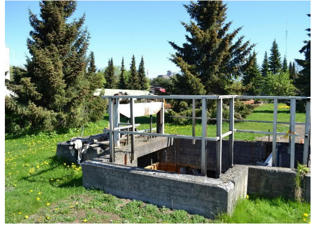
Kalkin ja ferrisulfaatin syöttöasema esiselkeytyksen ja ilmastusaltaiden välissä.
