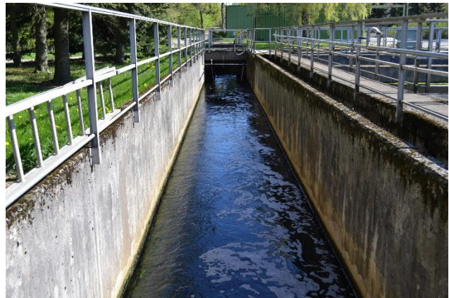
Jälkiselkeytyksen poistokanava, josta puhdistettu vesi johdetaan Pyhäjärveen.
