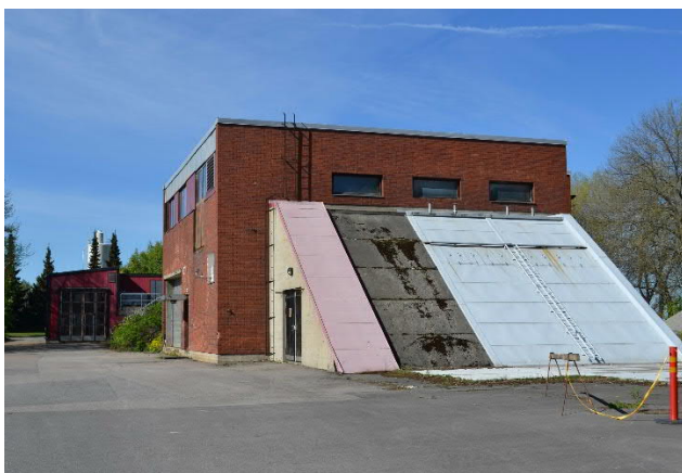
Vino katto kattaa pumppaamon nousuputket.
