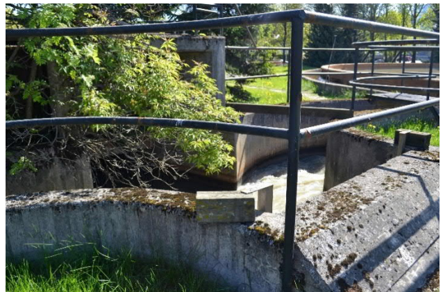
Liettekanavia. Keskellä vasemmalla pumppaamo.
