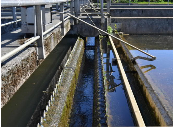
Jälkiselkeytyksaltaan mekaanisia puhdistimia.
