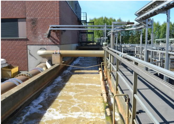
Ilmastusaltaiden jakokanava kompressorirakennuksen vieressä.
