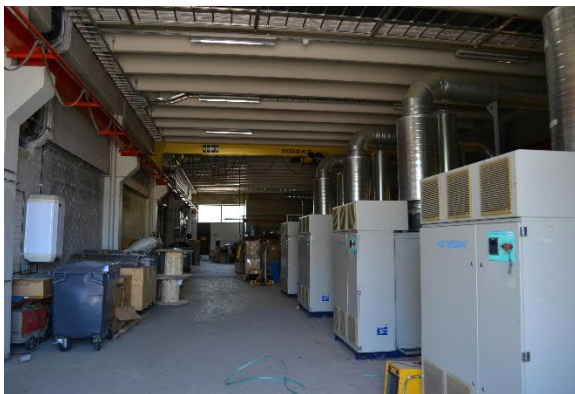
Kompressorihuone. Laitteistot vaativat riittävästi avointa tilaa.
