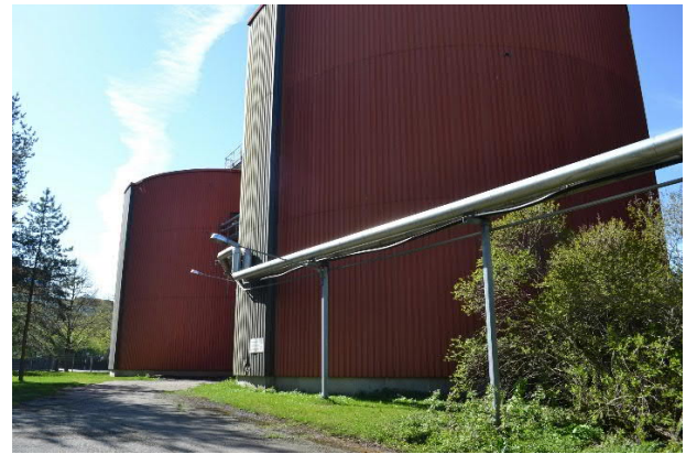
Takajulkisivu koilliseen. Putki johtaa kaasupolttimelle.
