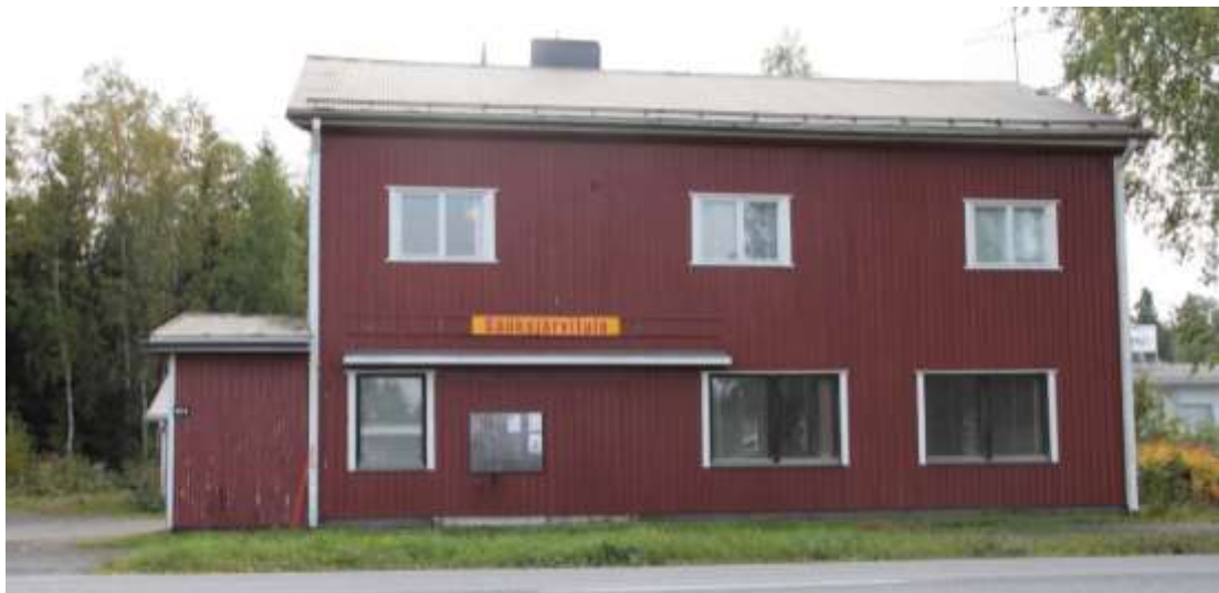
Kuva 18. Sääksjärvitalon Tampereentien puoleinen julkisivu. Ikkunat on uusittu. Kaupan entisen sisäänkäynnin yllä ollut ajalle tyypillinen lippa on säilynyt julkisivussa, vaikka sisäänkäynti on rakennettu umpeen. 2770
