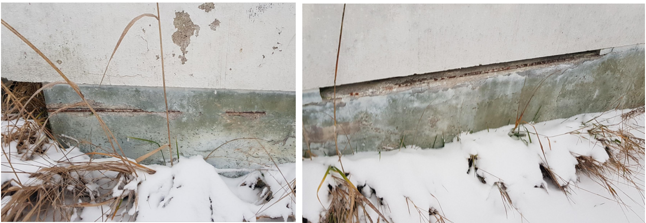
Kuva 21 ja 22: Sokkelin rakenneteräkset ovat näkyvissä monin paikoin ja sokkelista on irronnut suuriakin paloja
