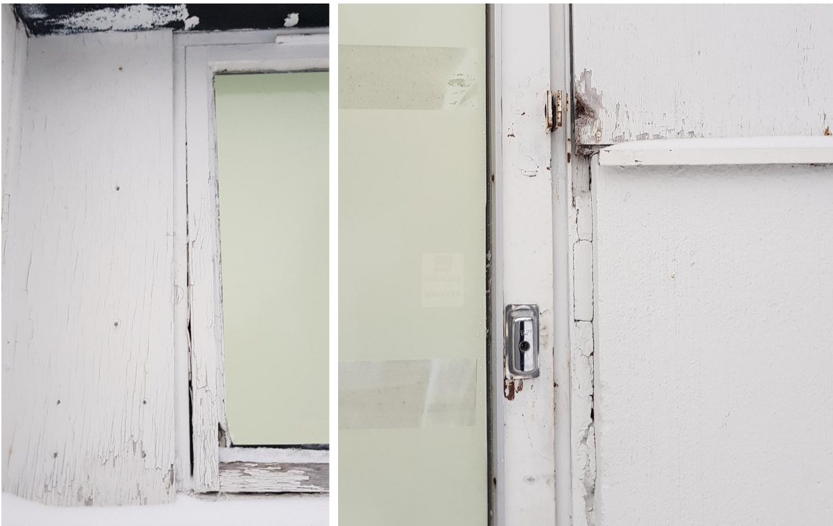
Kuvat 42 ja 43: Nauhaikkunat on joko teipattu sisäpuolelta peittoon tai peitetty ulkopuolelta rakennuslevyllä
