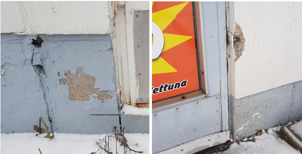
Kuva 23 ja 24: Henkilökunnan sisäänkäyntioven kohdalla sokkelissa näkyvät jäljet oviaukon puhkaisemisesta, ravintolan käyntioven oikealla puolella rakenneteräs näkyvissä. Molemmat ovet on tehty jälkikäteen.
