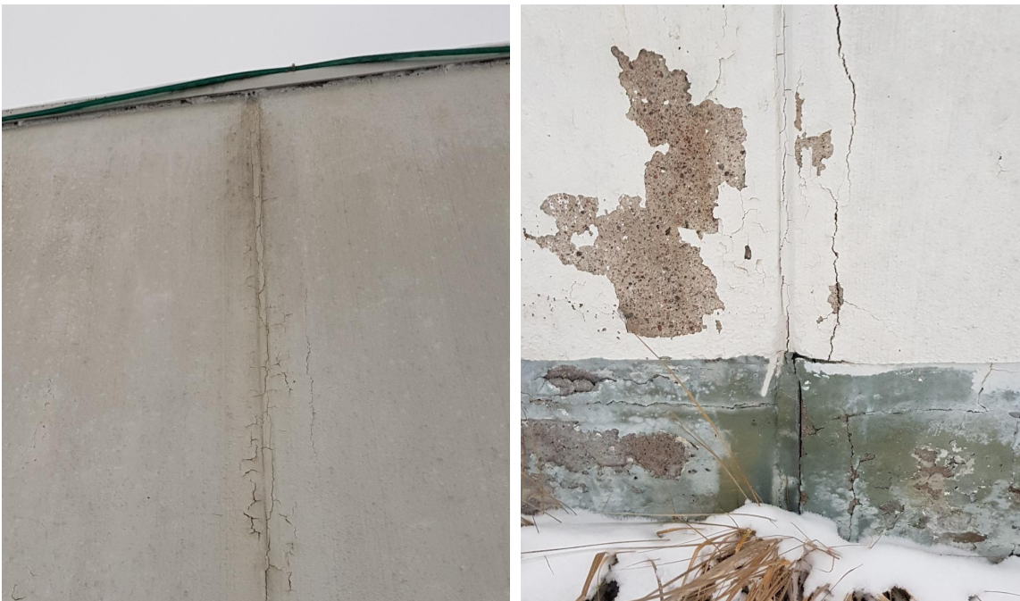
Kuvat 27 ja 28: Maali halkeilee elementtisaumojen kohdalta, betonielementeissä nähtävillä murtumia
