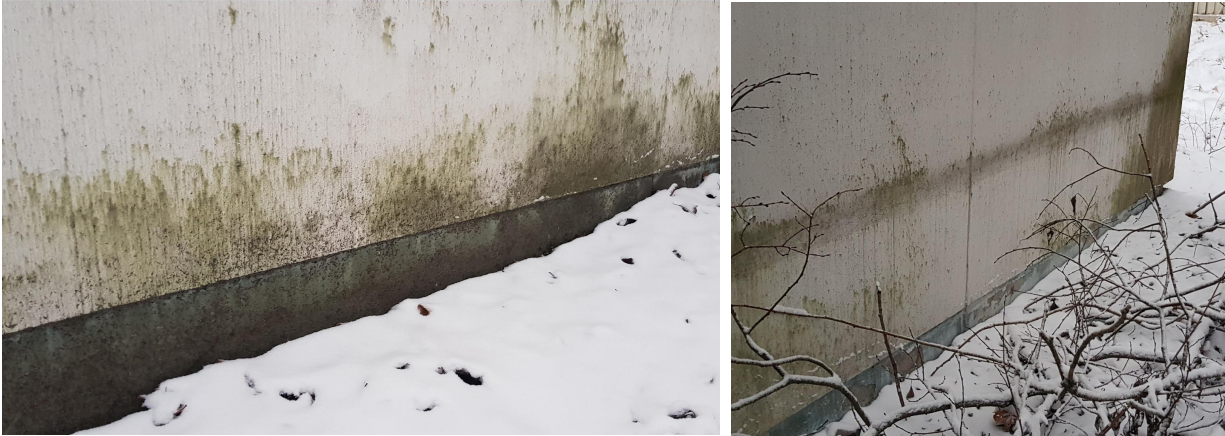
Kuvat 25 ja 26: Sokkeli on tummunut ja betonissa on näkyvää homekasvustoa ja kosteusvaurioita.
