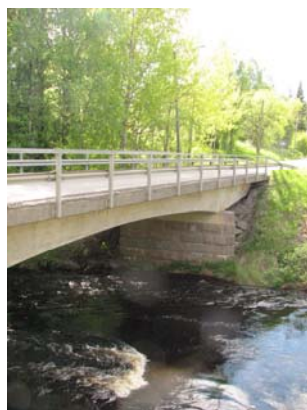
Kuva: Aureentiehen liittyen Viinikanjoen ylittää autoliikenteelle tarkoitettu kapea betonikaarisilta, johon liittyy lohkokiviset maatuet. Sen vieressä on betoninen kevyen liikenteen betonilaattasilta. Vanhempi autosilta on kapeudesta päätellen rakennettu ennen maantieliikenteen kasvua ja uudistumista 1960-luvulla.
