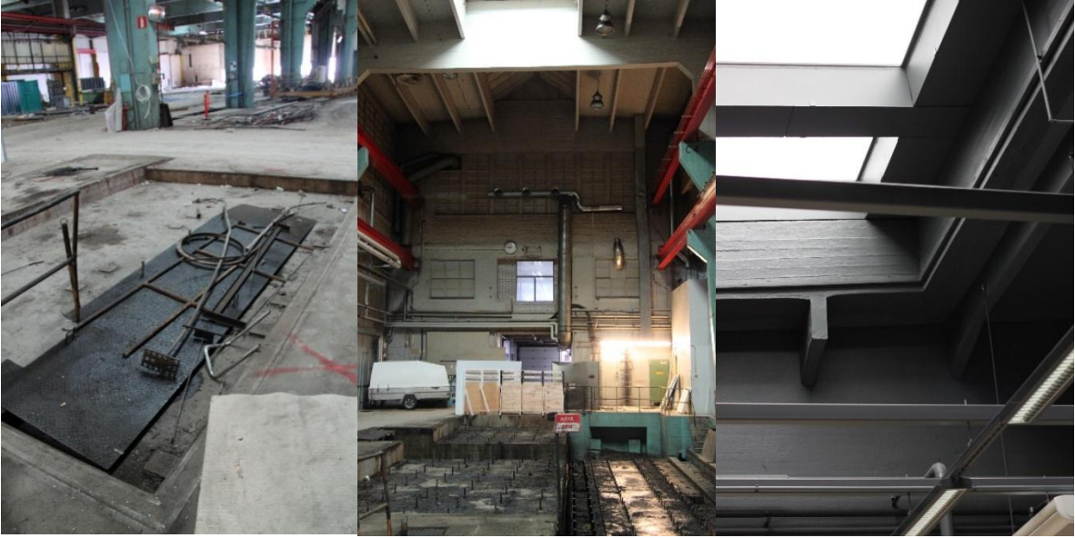
Kuva 59: Lattiaa C-hallissa Kuva 60: Kerroksellisuutta C-hallin itäseinällä: umpeen maalattuja ylä- ja kattoikkunoita Kuva 61: Kattoikkuna 2. kerroksessa
