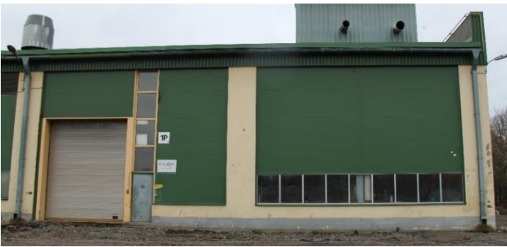
Kuva 62: Julkisivun kerroksellisuutta: alkuperäiset ikkunat on korvattu Paroc-elementeillä ja nauhaikkunoilla. Katolle on lisätty iv-konehuone.
