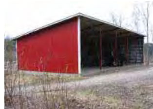
Konekatos /9/ kaakon suunnasta. Rinteessä oleva teräsristikkorakenteinen poimulevyvuorattu kylmä konehalli on noin 1990-luvulta.
