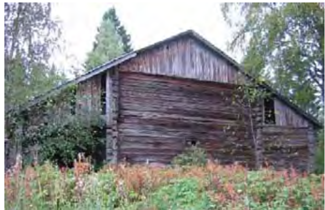
Riihen /5/ pääty. Riihirakennuksessa on kaksi pitkänurkkaista, vuoraamatonta hirsistä kuivausriihtiä. Paririihen kummallakin pitkällä sivulla on rankorakenteiset kylkiäiset.
