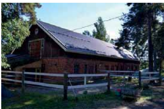
Kookas navetta (2): betonisokkeli, runko muurattu poltetusta tiilestä. Ikkunat ja ovet alkuperäiset, ovissa ajalle tyypillinen vinopanelointi. Katto uusittu 2000-luvulla.
