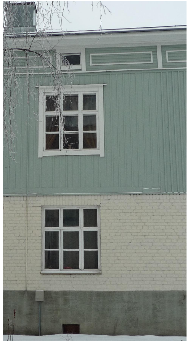
Ote etelä-julkisivusta. Oikealla korjattua alkuperäistä kapeampaa rimalaudoitusta. Ikkunan ympärillä alkuperäinen rimavuoraus.
