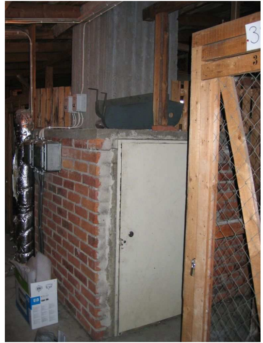
Viereisen ilmanvaihtokojeen koppi CD-osan ullakolla
