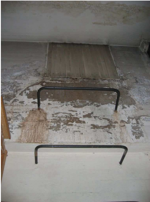
Varastotilasta luukku pihalle, korjattu vesivahinko 1995
