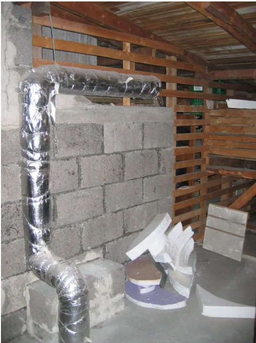
Vanhan öljypoltinhormin taustarakenteita, joista oikeastaan kukaan ei tiedä mitkä ovat tarpeellisia
