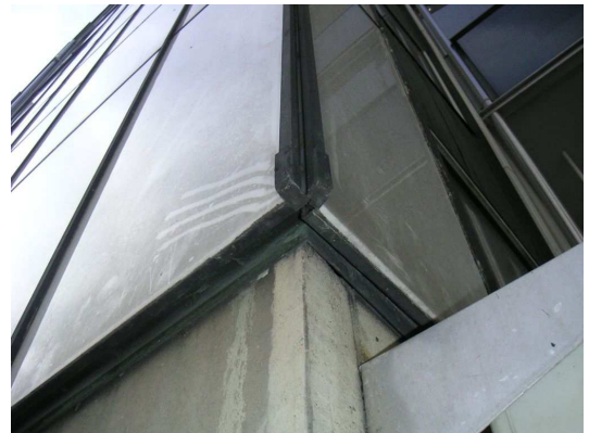
Julkisivudetalji C-rapun edessä. Pääosin kiinnikkeet ovat kellokunnossa.
