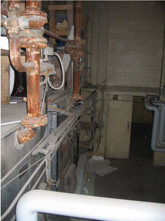
Kellarin tekninen tila, vanhat öljypolttimet
