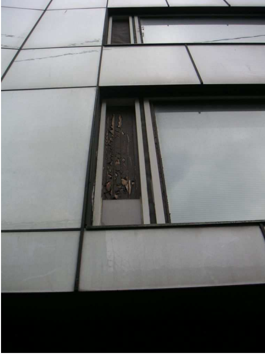
Tuuletusikkuna länsisivulla erkkerin kohdalla. 80-luvun maali kuorii pois.
