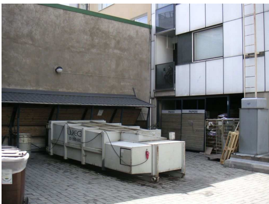
Taloyhtiön jätejärjestelmät pihan eteläpäädyssä
