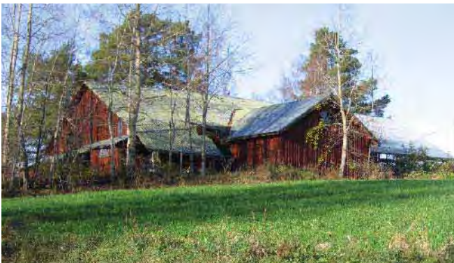
Riihirakennus kaakosta päin nähtynä. Siipiosan päädyssä on lunetti-ikkuna, jossa on 8 säteittäistä sektoria ja kaareva välipuite (mahdollisesti vanha kirkon ikkuna).
