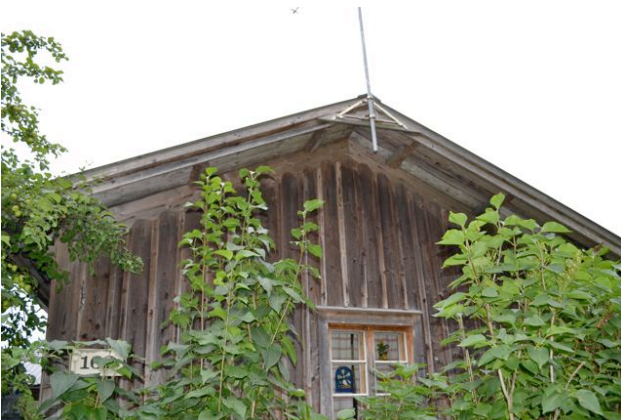
Joissain kohteissa on verhouksen ylälistana on veistetty kaarifräsi. Päivärinta.
